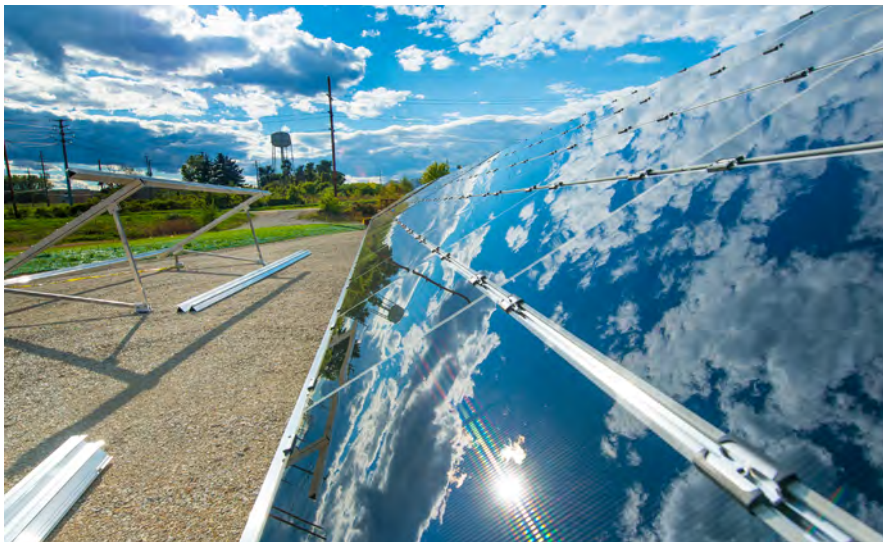
Existing solar PV array
